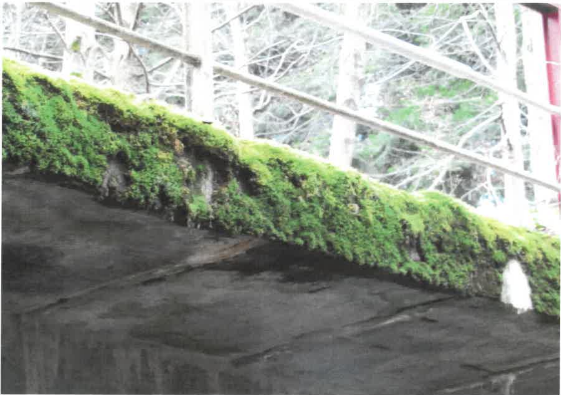
FOT. 2.4 - Opis uszkodzeń: wegetacja roślinności, zarysowanie, ubytki, korozja betonu płyty ustroju; przecieki i wykwity
