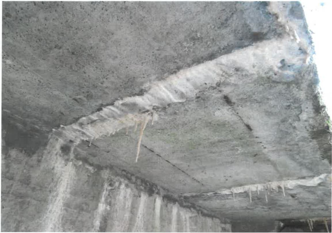
FOT. 2.3 - Opis uszkodzeń: przecieki i wykwity na spodzie ustroju
